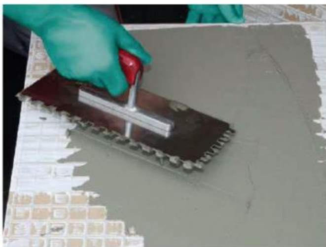
17 Використання комбінованого методу при приклеюванні облицювання залежить від формату і властивостей основи плитки і служить для досягнення повного зчеплення облицювання з основою.
